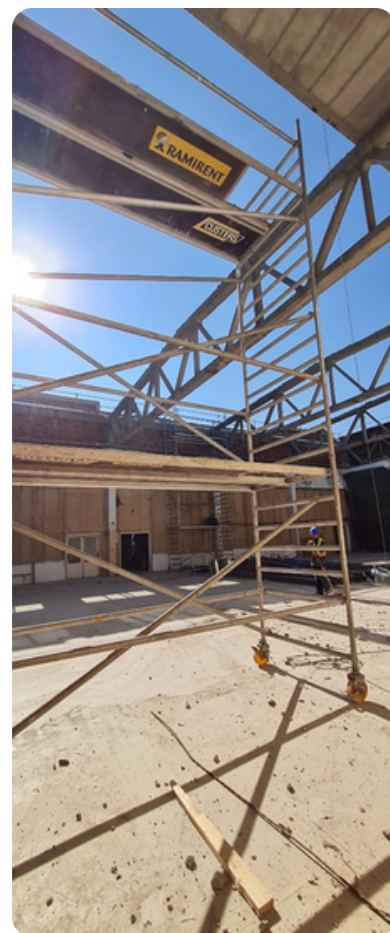
Staré nosníky byly již v havarijním stavu, byly proto nahrazeny
